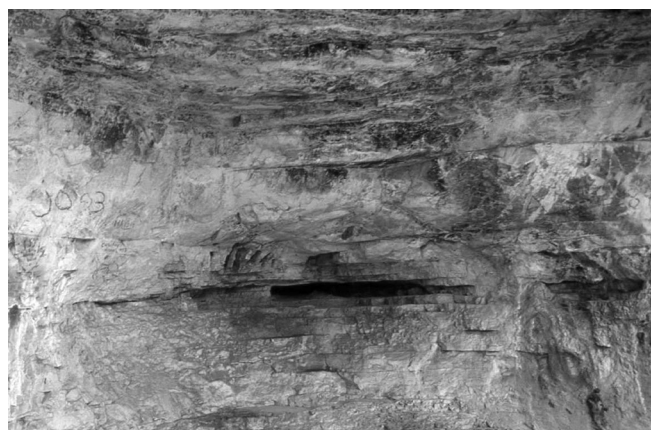
Figure 65 – Renforcement central et fissuration horizontale de la paroi.
