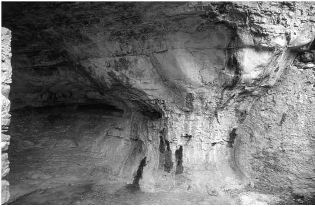
Figure 66 – Encroutements de calcite au niveau des sorties d'eau : partie droite du renforcement.
