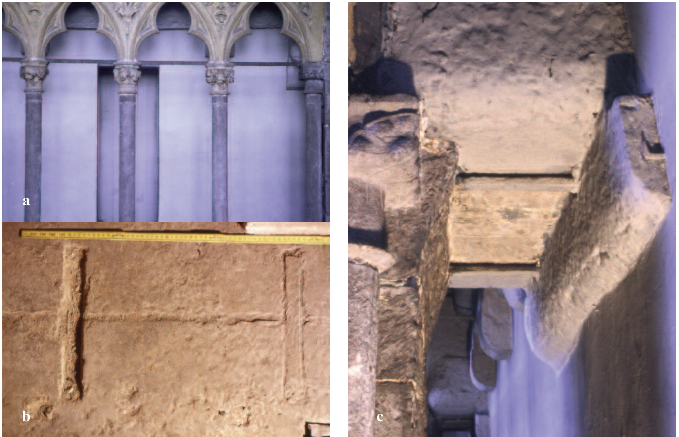
Figure 15. Liège, cathédrale Saint-Paul, nef, triforium; emploi du métal: (a) tirant entre les abaques des chapiteaux, (b) crampons liant les dalles de sol, (c) étréssillons placés au droit des supports
