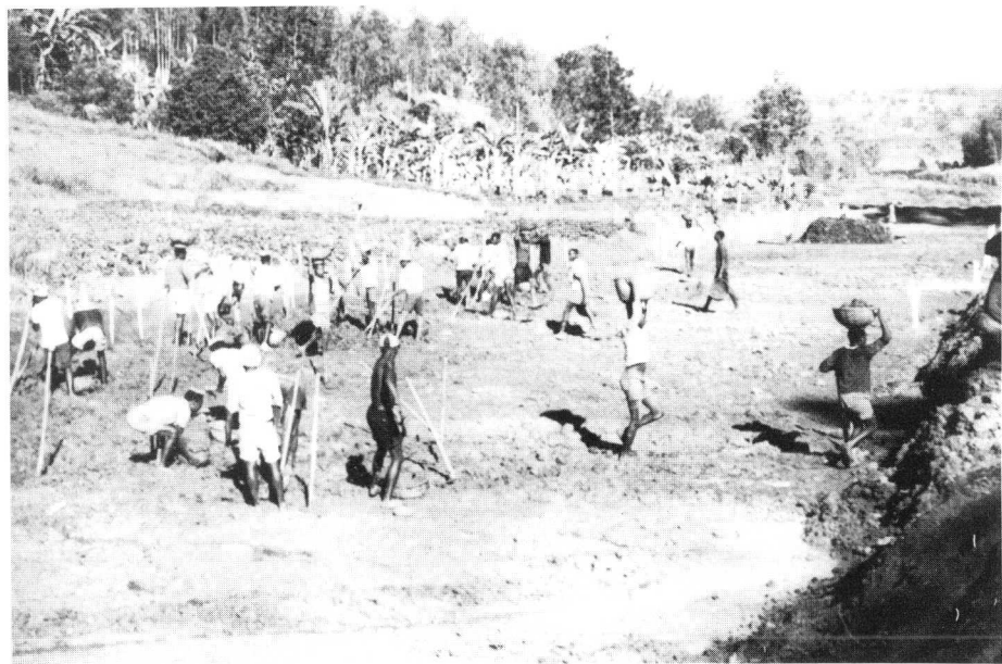
Photo 2. Récupération et entassement des terres organiques lors de la construction d'un système agro-piscicole.
